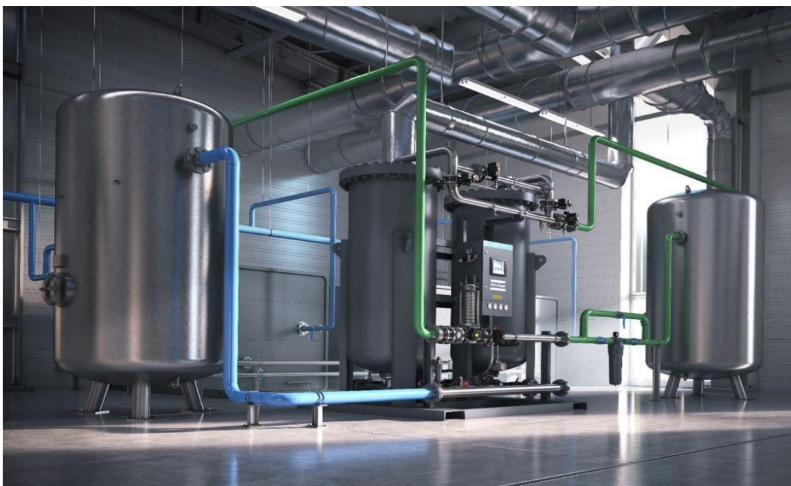
Figure 2- 1 : Unité de production d'azote
