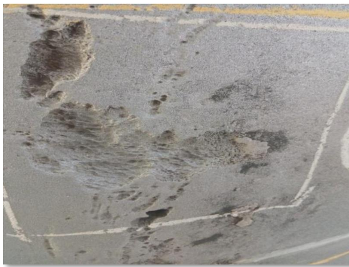
Figure II.8 Corrosion localisée sur un pipeline (terminal de Béjaia)
