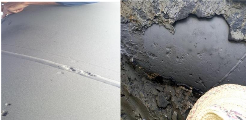
Figure II.9 Corrosion par piqure sur un pipeline (terminal de Béjaia)
