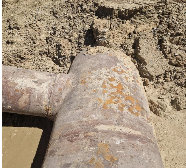
Figure II.7 Corrosion généralisée ou uniforme sur un pipeline (terminal de Béjaia)
