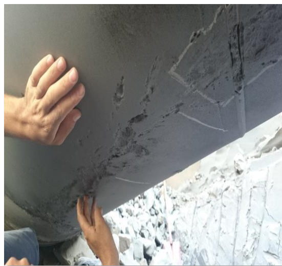
Figure II.10 Corrosion caverneuse sur un pipeline (terminal de Bejaia)
