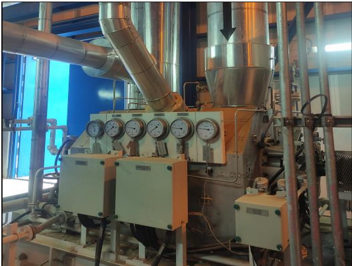
Figure II 8 Pompe alimentaire de la chaudière
