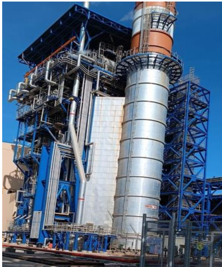
Figure I 8 vue d'extérieur de la chaudière de récupération
