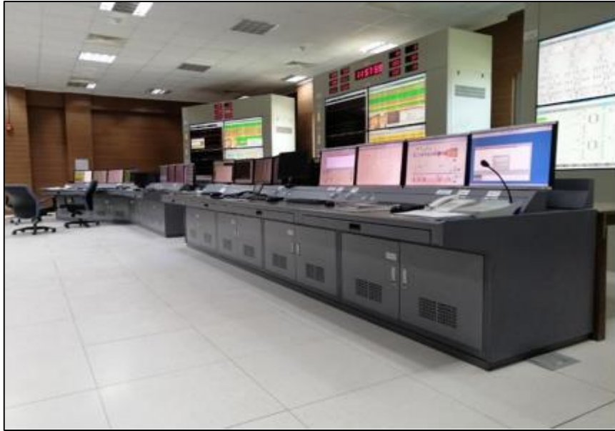
Figure I 17 Salle de commande de la centrale à cycle combiné
