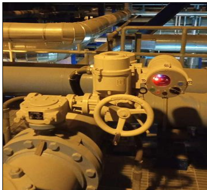
Figure III 23 Vanne motorisé d'isolement
