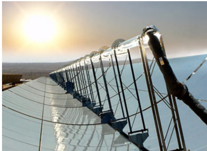
Fig. II.14 : Capteurs cylindro-paraboliques de la centrale Nevada Solar One [44]
