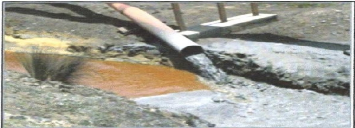
Figure II.2 : évacuation de l'eau de L'exhaure (photo internet)
