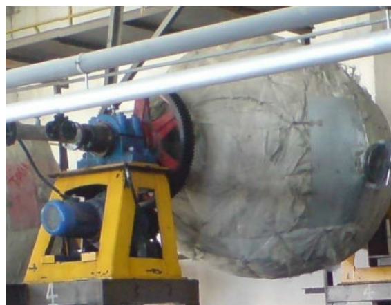
Figure I.8 : Tank où se déroule le séchage.
