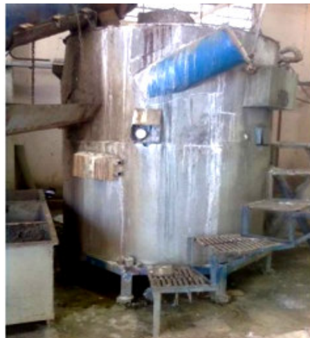
Figure 1.7 : Cuve de lavage.
