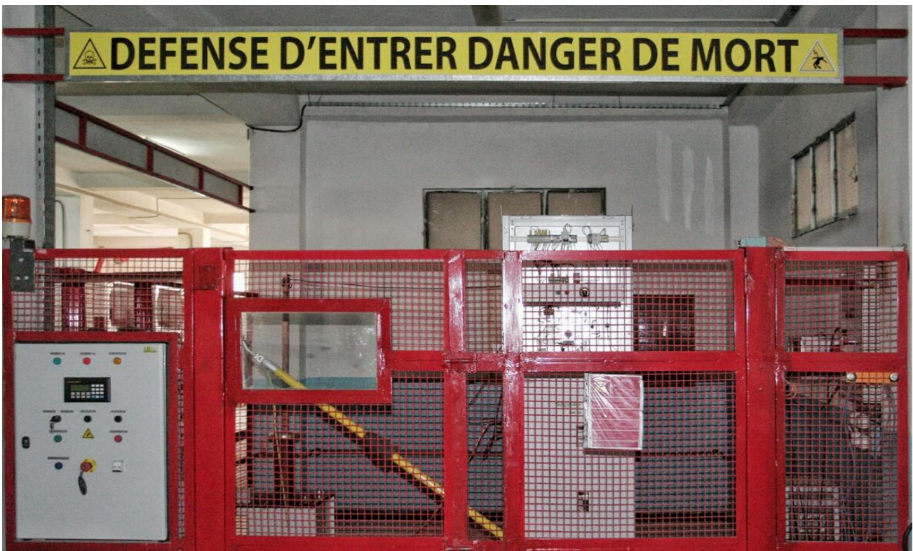
Figure 8 : Zone de teste des cellules SM6
