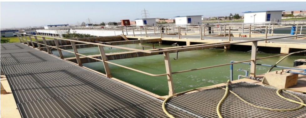
Figure II.4. Chambre de répartition
