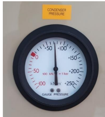
Figure 3.12 – Manomètre du condenseur
