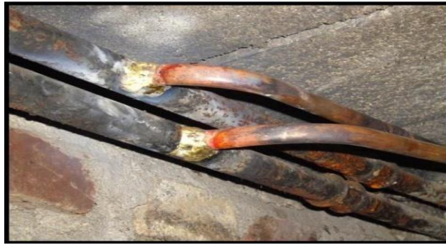
Figure I.2 : corrosion chimique de cuivre et d'acier noir dans une installation
