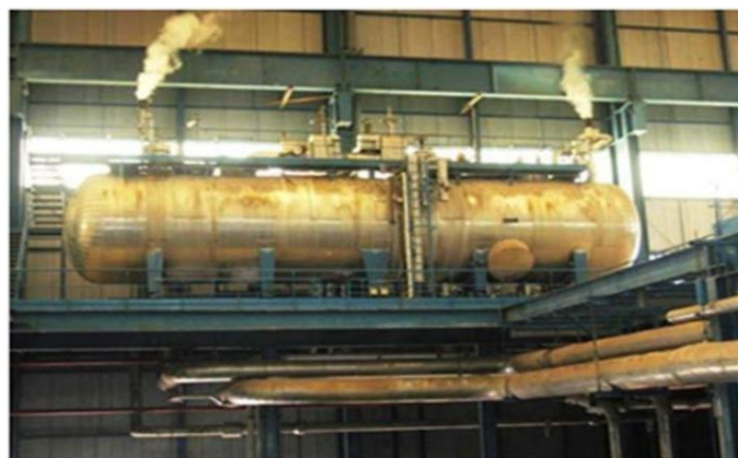
Figure (1.6) : Vue de bâche alimentaire de la centrale.
