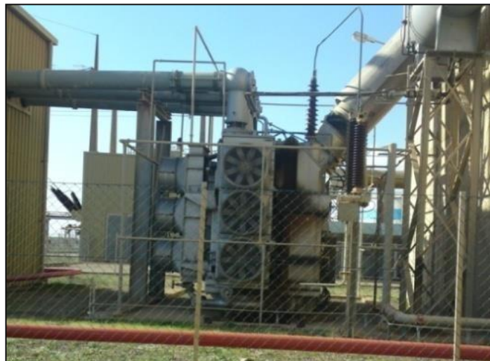
Figure (1.10) : Transformateur principal. [2]
