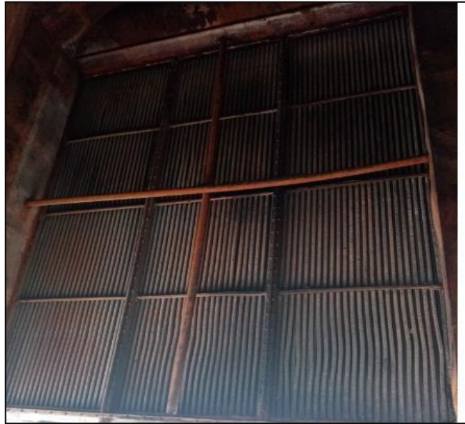
Figure (1.2) : Le préchauffeur d'air à vapeur. [2]
