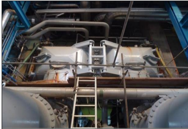
Figure (1.5) : le condenseur de la centrale de RAS DJINET. [2]
