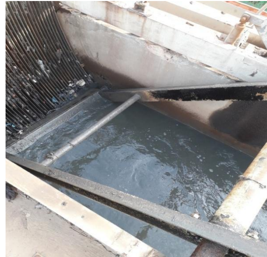
b) Dégrilleur automatique
