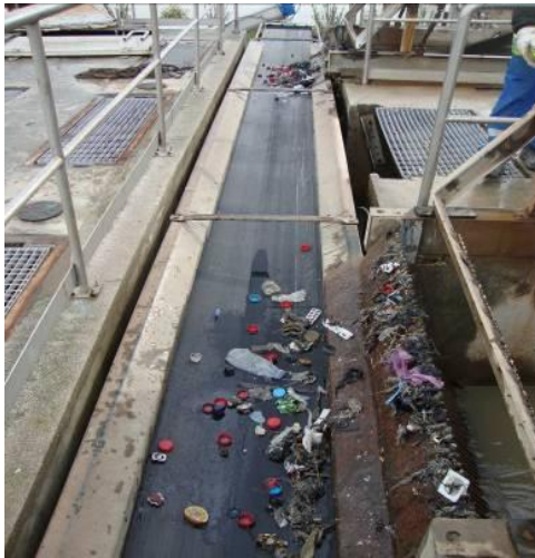
a) Dégrilleur manuel
