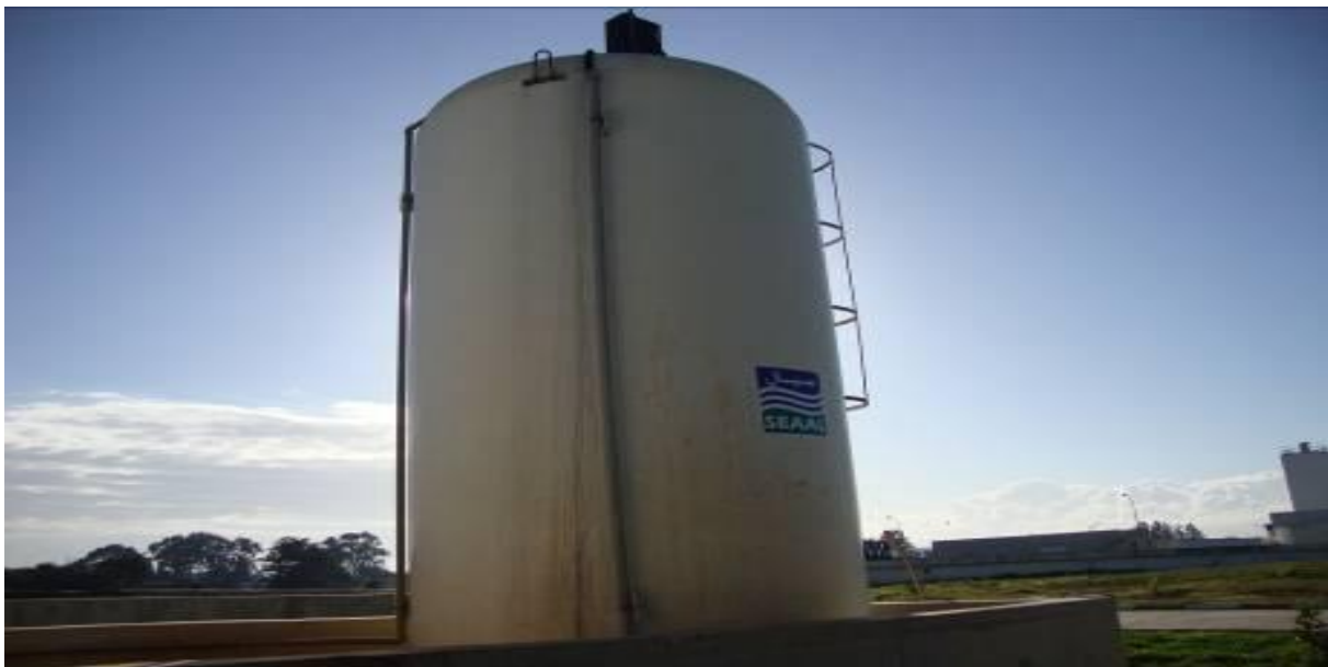
Figure III.7 : Cuve de stockage du \text{FeCl}_3
