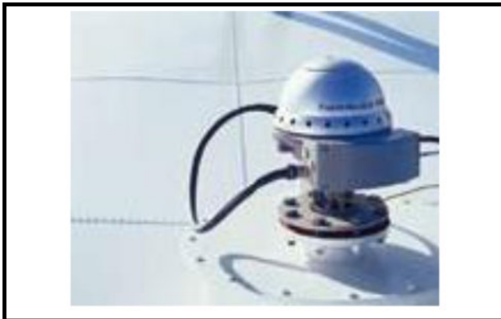
Figure VI .4 : Jaugeur du réservoir
