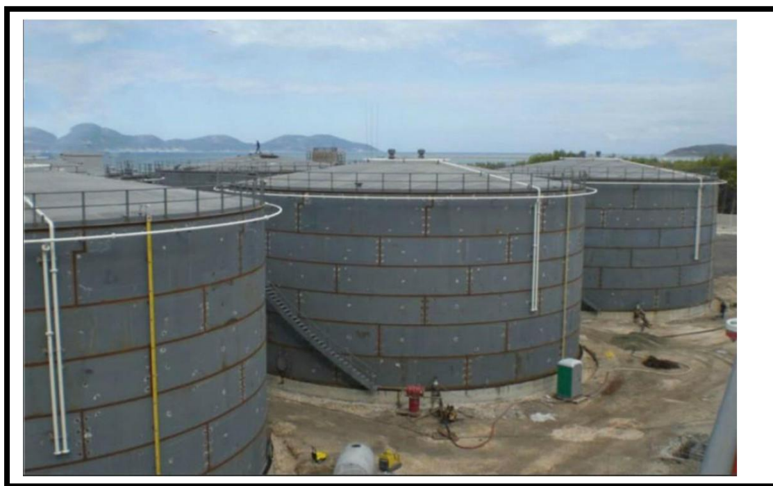
Figure I.8 : Réservoir cylindrique a toit fixe
