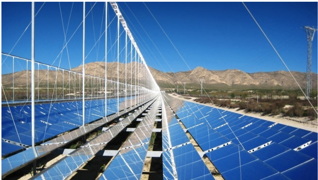
Fig. 2.7. Le Puerto Errado - centrale thermique à collecteur de Fresnel (Murcie, sud de l'Espagne)
