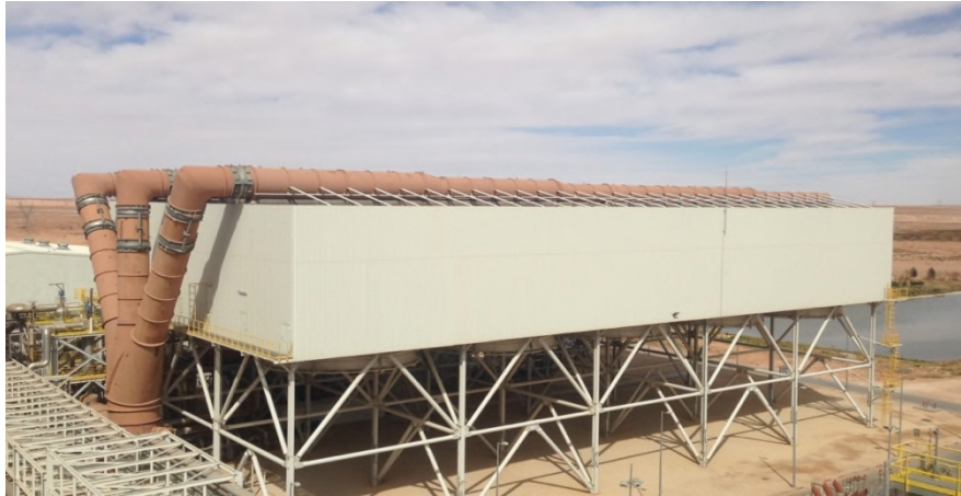
Fig.3.7. Photo des aérocondenseurs
