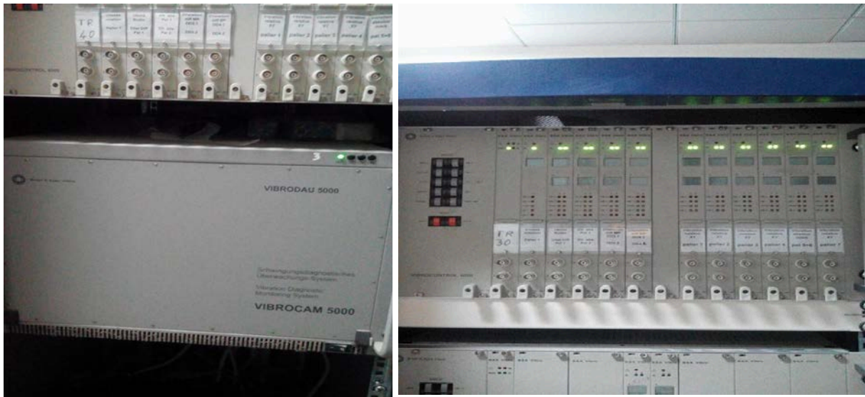
Figure 4. 2. Photo de système de control ON-LINE.
