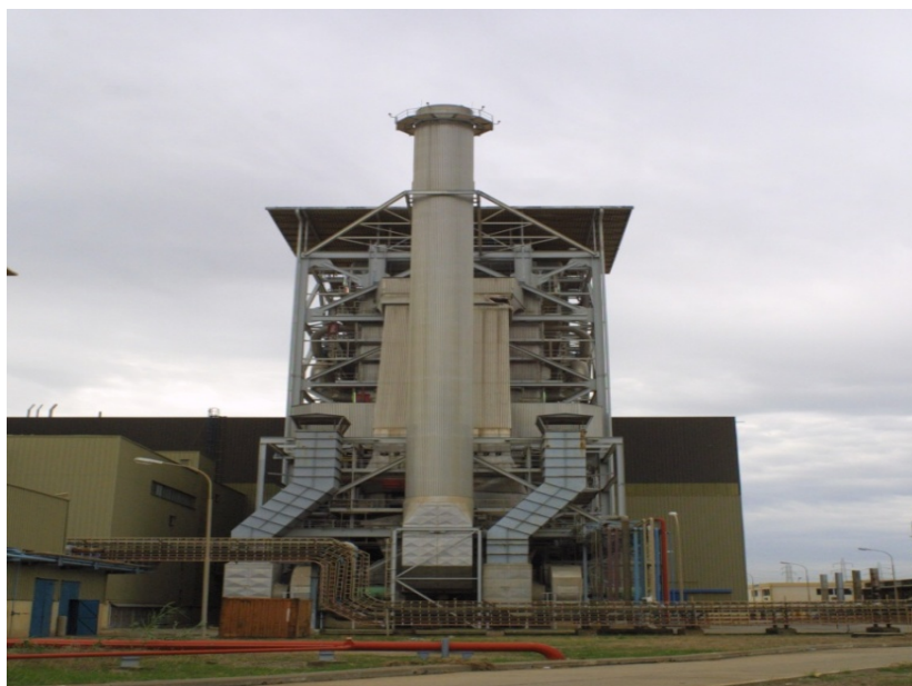
Figure 1. 2. Chaudière de la centrale de Cap Djinet
