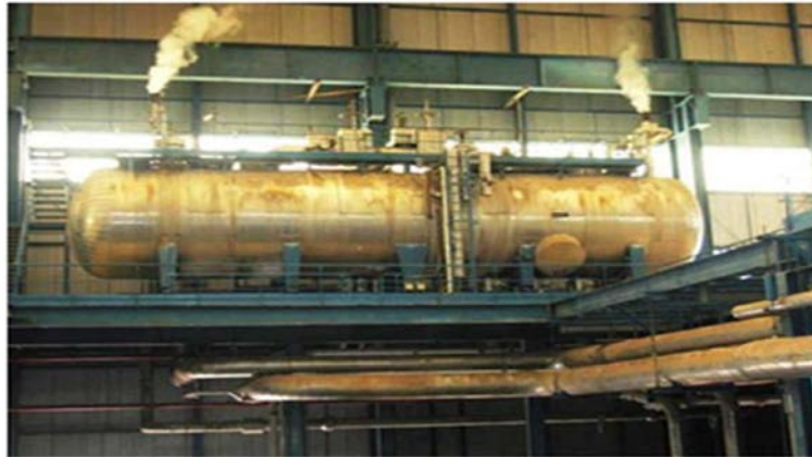
Figure 1. 8. Vue de bache alimentaire de la centrale
