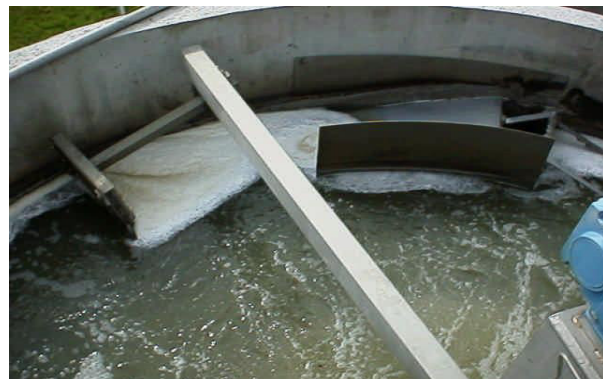
Figure N°9 : Racleur des graisses d'un dégraisseur
