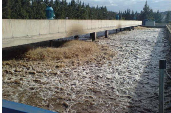
Figure N°11 : Aération dans un bassin biologique.
