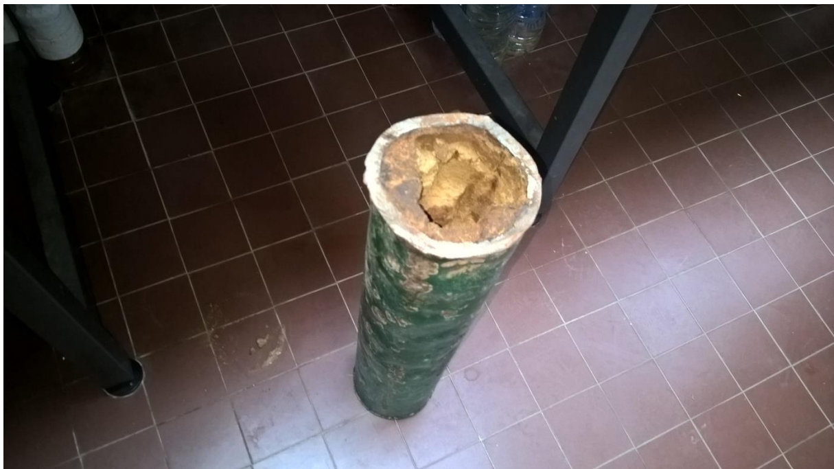
Figure B. Un bouchage de canalisation par un dépôt de carbonate de calcium
