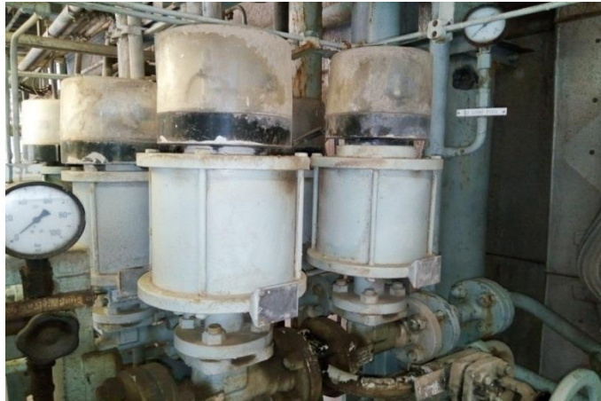
Figure 3.14 : Les vannes fermeture rapides (TOR pneumatique)
