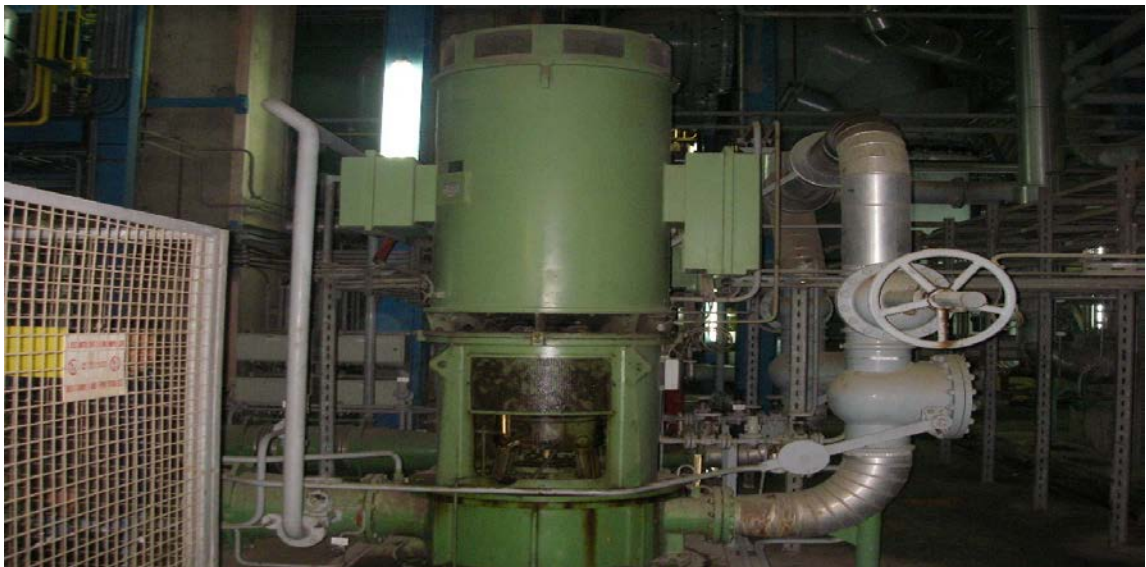
Figure 1.6 : La pompe d'extraction
