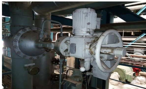
Figure 3.13 : La vanne régulatrice
