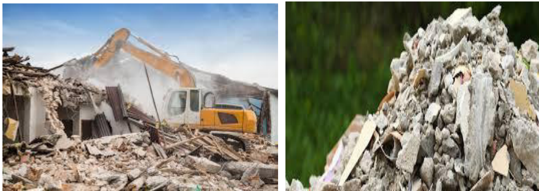
Figure II.6. Déchets de chantier
