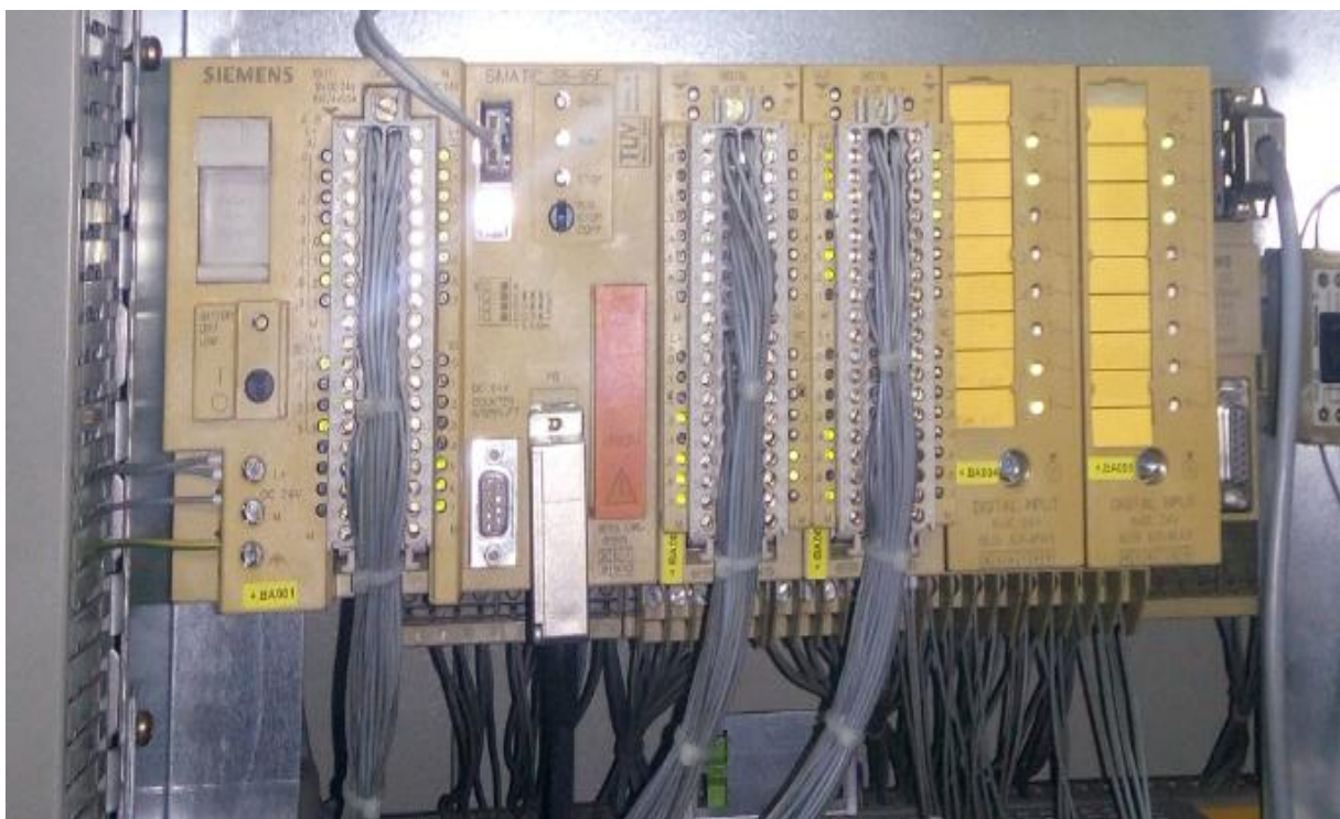
Figure IV.1 API de la gamme SIEMENS S5.
