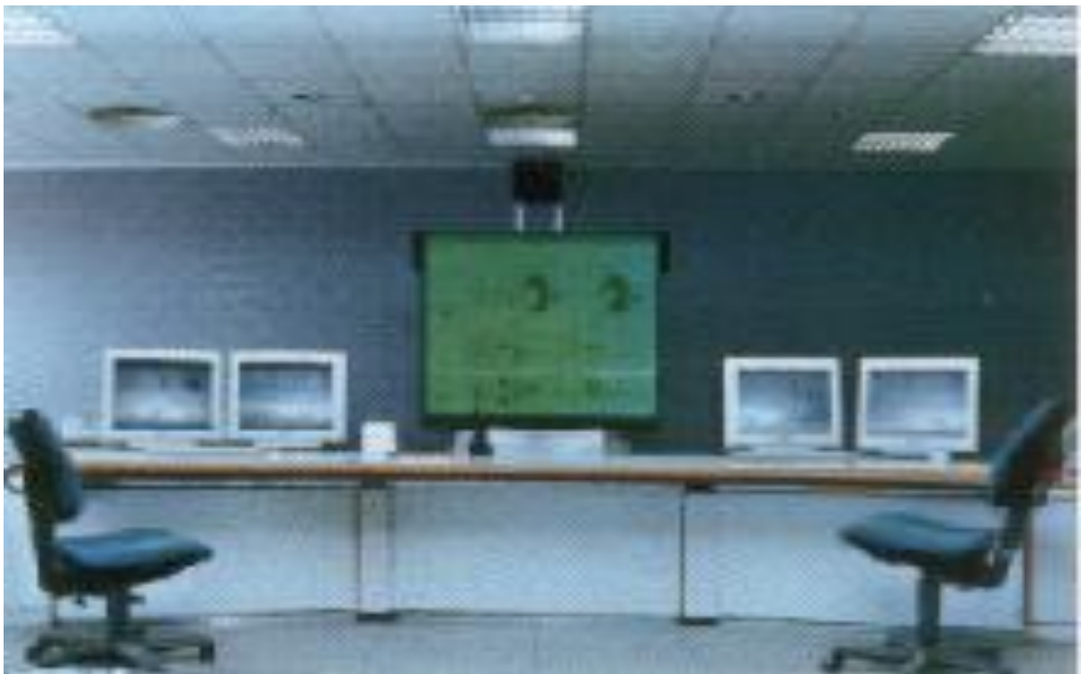
Figure I.9 Vue de la salle de commande.
