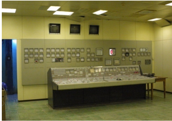
Figure I.7: Salle de commande
