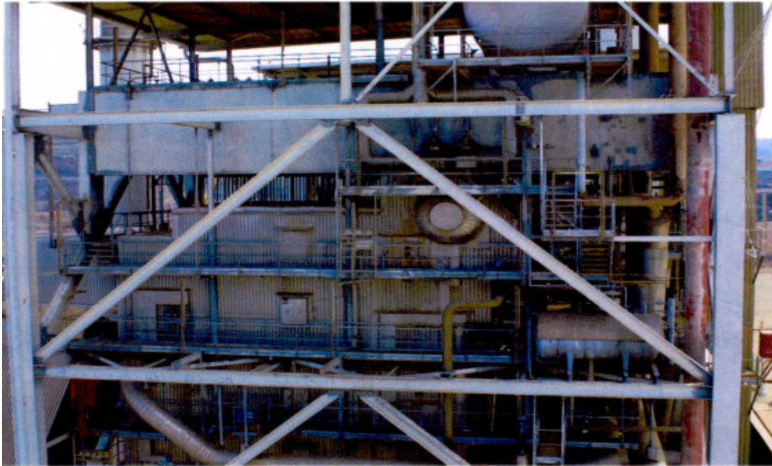
Figure I.1 : Chaudière de la centrale de Cap Djinet
