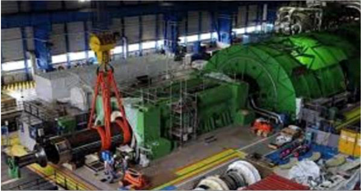
Figure (I-9) : Alternateur de centrale CAP-DJINET
