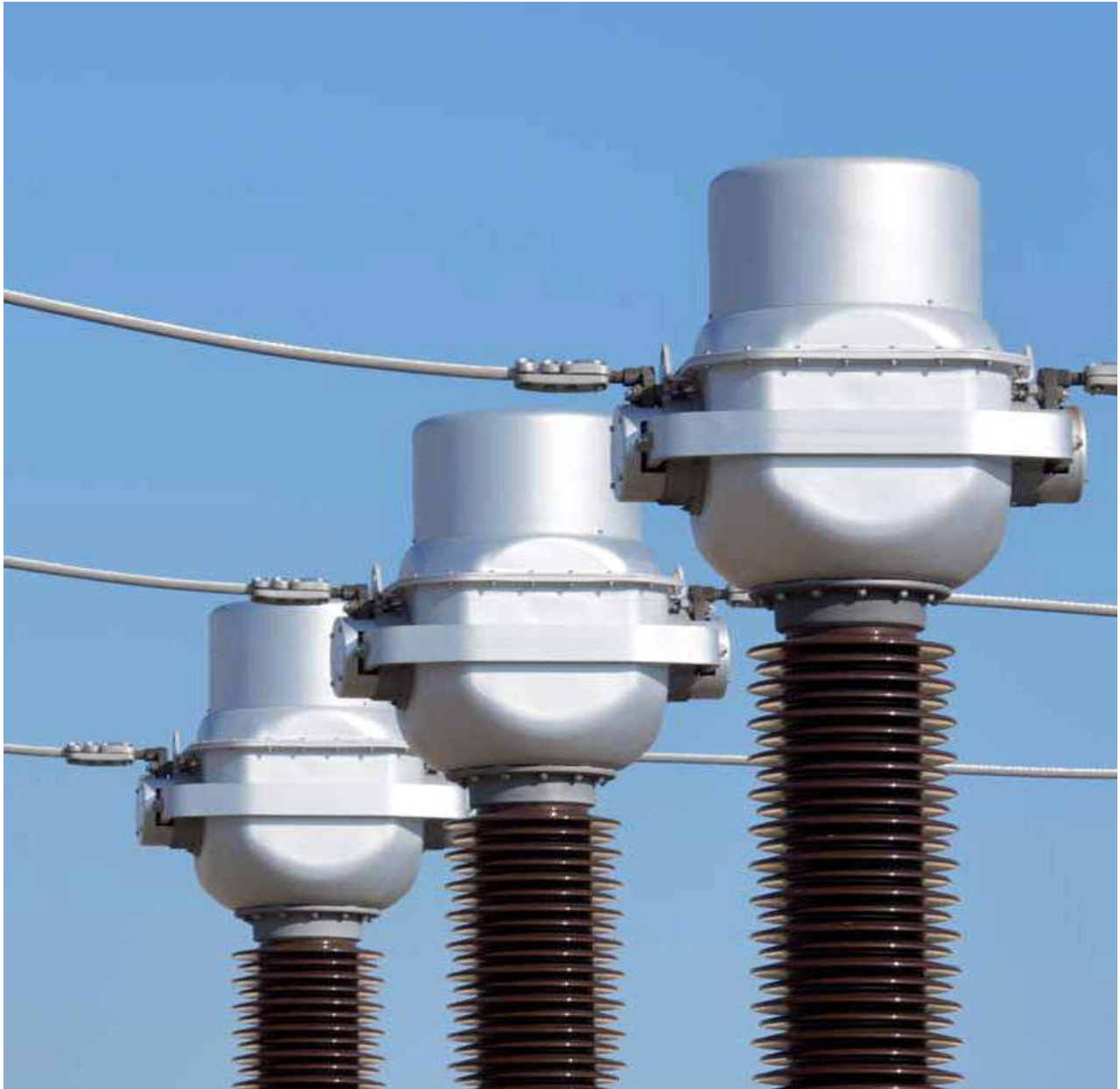
Figure(II-2) : Transformateur de mesure immergé a bain d'huile au sol
