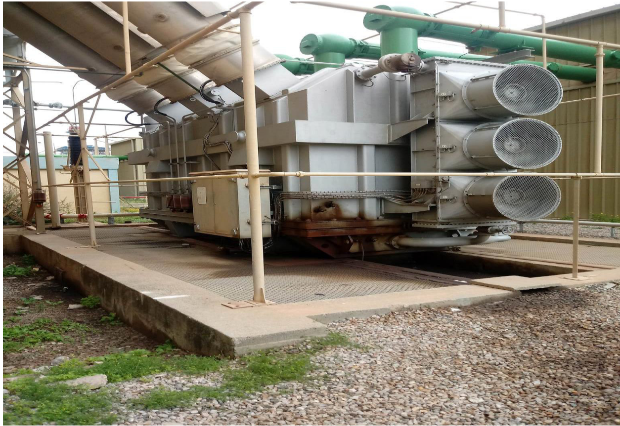
Figure(I-10) : Transformateur principal
