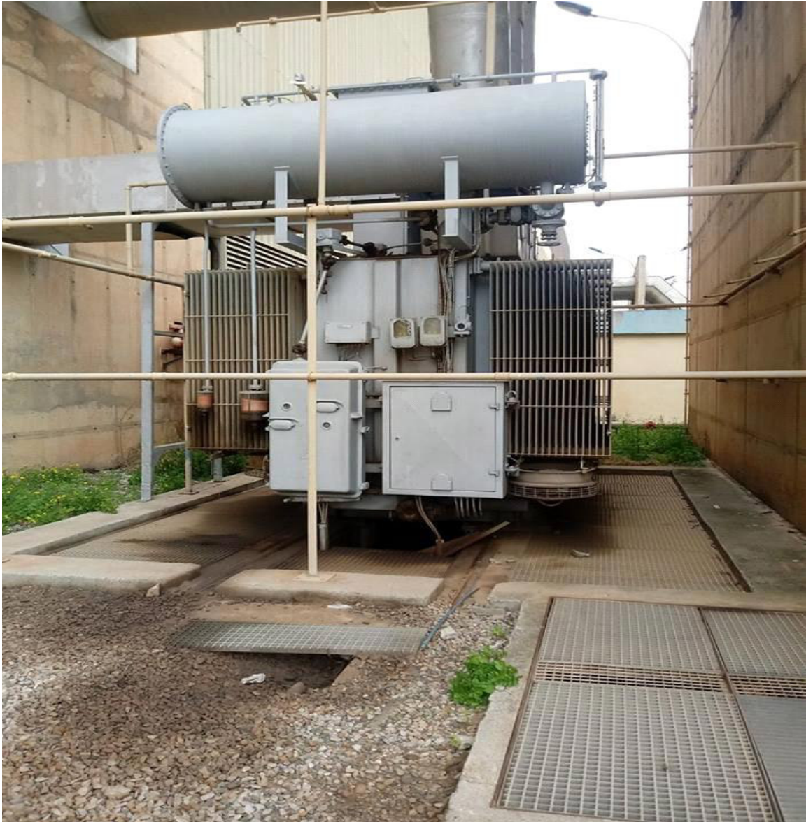
Figure(I-11) : Transformateur secondaire de CAP-DJINET
