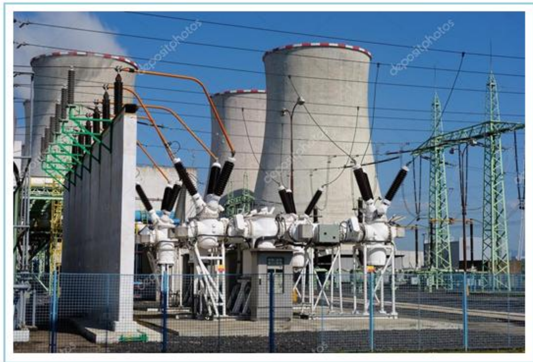
Fig. (I-14) : postes de transformation HTB/HTA.
