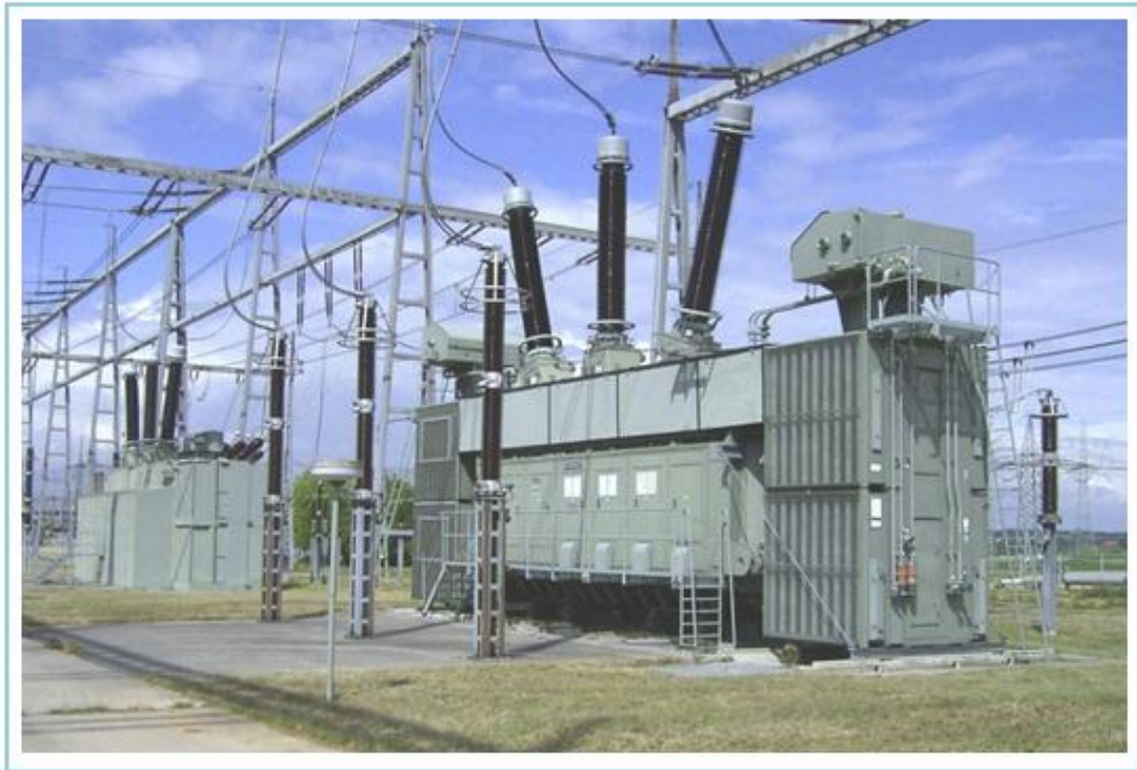
Fig. (I-15) : postes de répartition HTA/HTA
