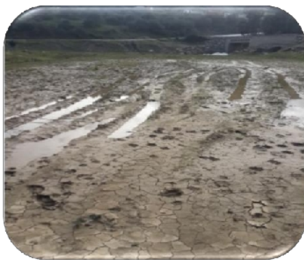
Figure III.3.1 : Envasement du barrage de keddara
