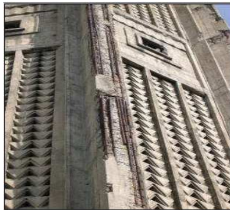
FigureN°13.la dégradation d'une structure en béton
