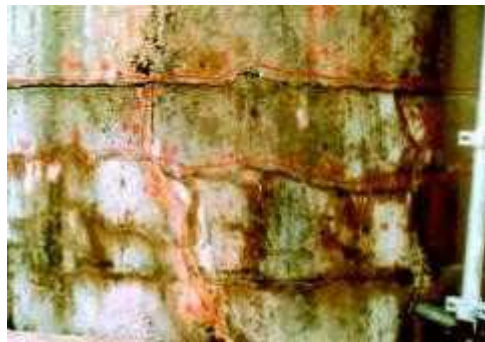
Figure N°17. Pile de pont affectée par une réaction de gonflement interne due à la formation d'étringite différée.
